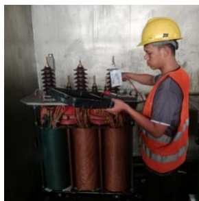
Gambar 3. Pengujian Tahanan Isolasi Menggunakan Megger Di PT Hariff Power Services
