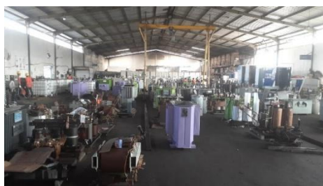
Gambar 4. Kondisi penyimpanan transformator di ruang terbuka di PT Hariff Power Services
